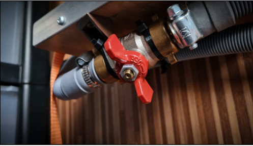
Kugelhahn am Abwasserschlauch
